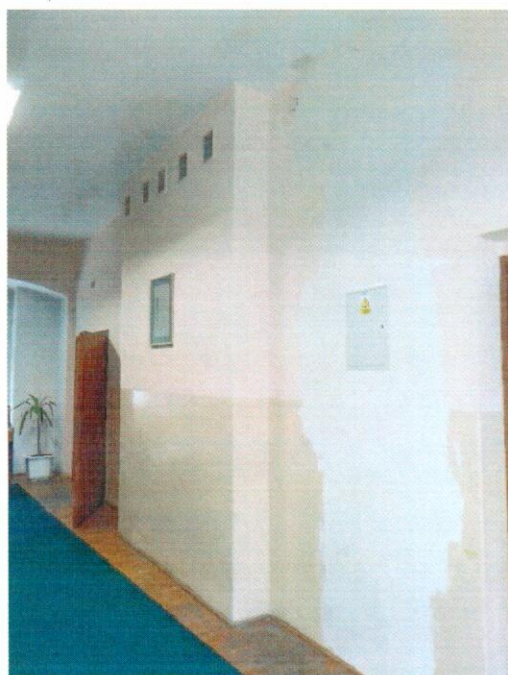
Rozdzielnia na I piętrze, po doprowadzeniu nowej linii zasilającej z RG na parterze
