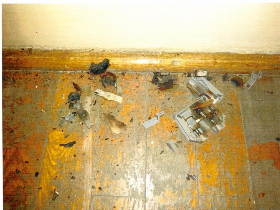
Spalona w dniu 23 grudnia 2019 r. rozdzielnic na I piętrze
