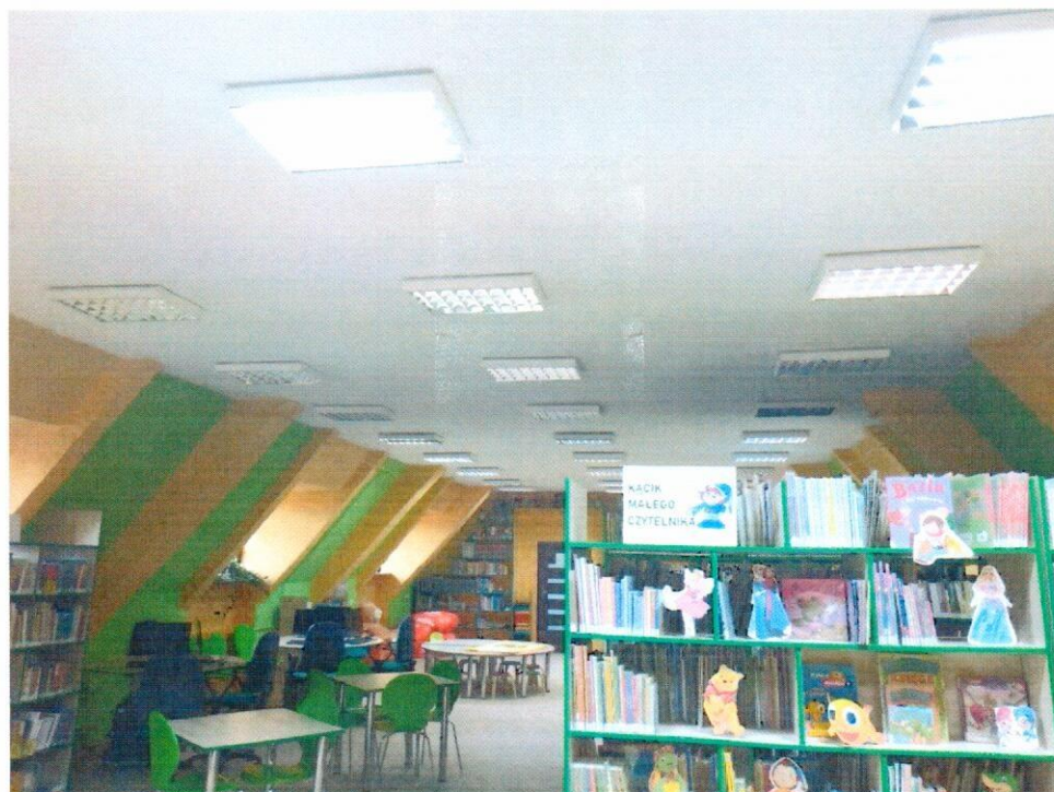
Nowe oświetlenie LED na Oddziale dla Dzieci, nowe oświetlenie LED na Baszcie
